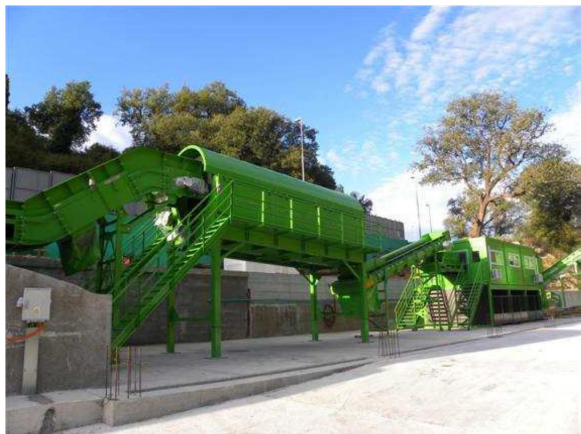
Slika 4 Postrojenje za obradu otpada
